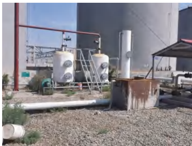
燃料油罐区废气治理措施采样口
