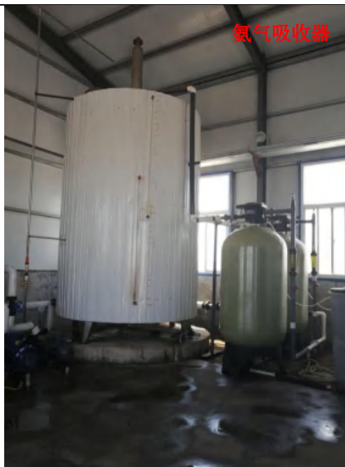
图 4.2-1 废气处理措施建设情况
