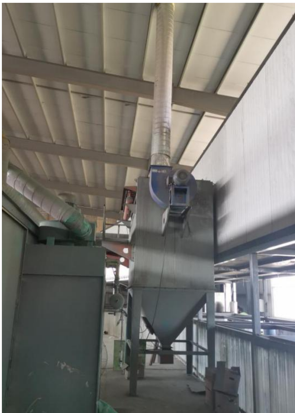
图4.1-3 布袋除尘器+15m高排气筒排放（P2）
