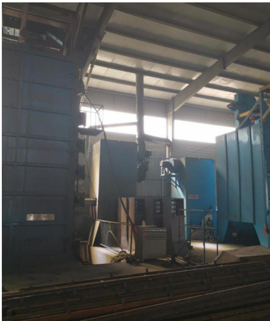
图4.1-2布袋除尘器及15m高排气筒 (P1)
