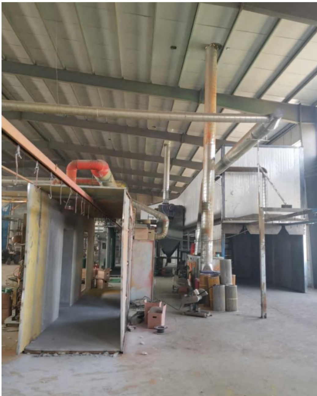
图4.1-6 集气罩及15m高排气筒（P3）
