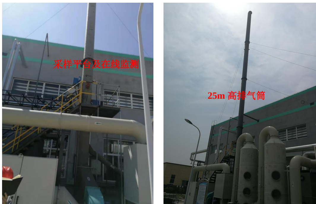
图 4.2-1 P1 排气筒废气处理措施建设情况
