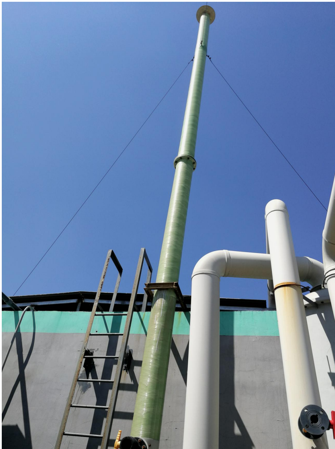
图 4.3-2 2#废气措施排气筒
