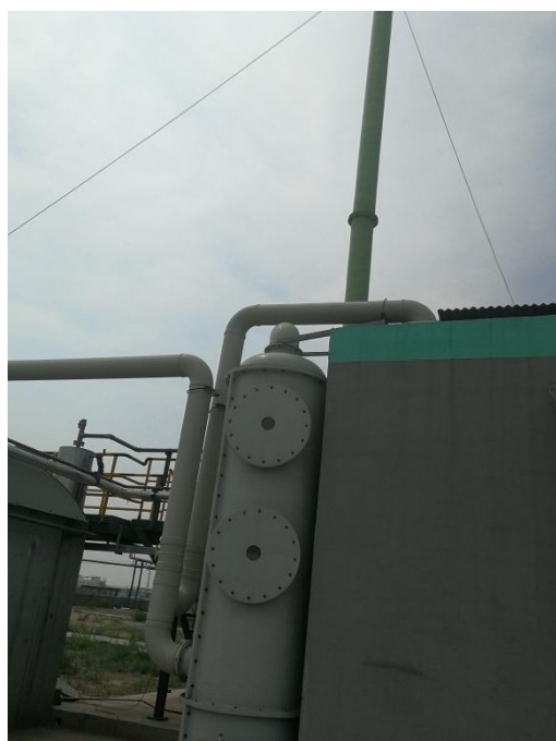
图 4.2-2 P2 排气筒废气处理措施建设情况
