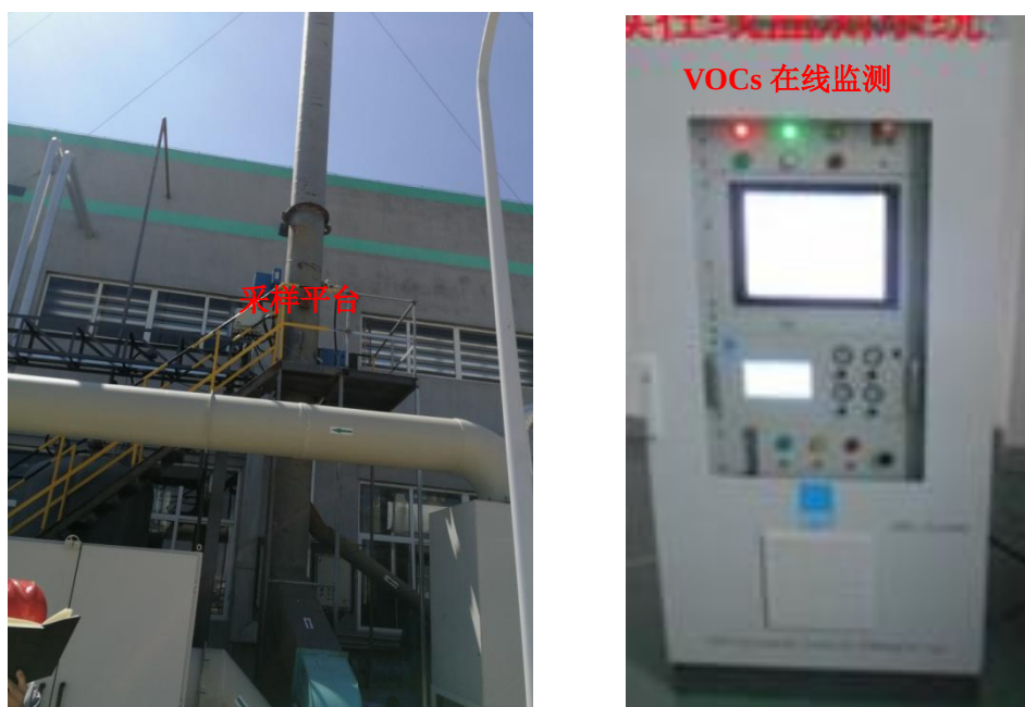
图 4.3-1 1#废气措施采样平台、排气筒、在线监测
