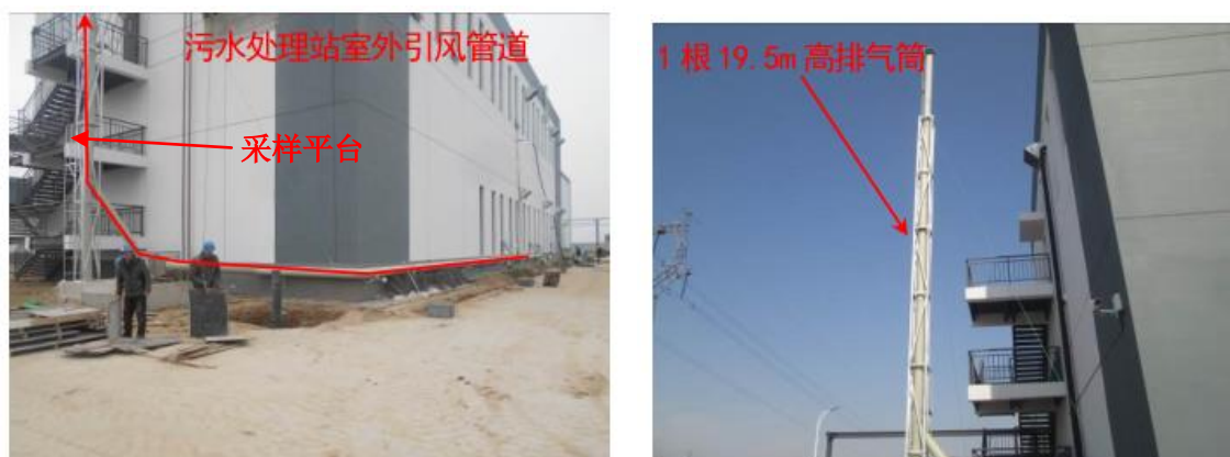
图 4.3-3 3#废气措施采样平台、排气筒
