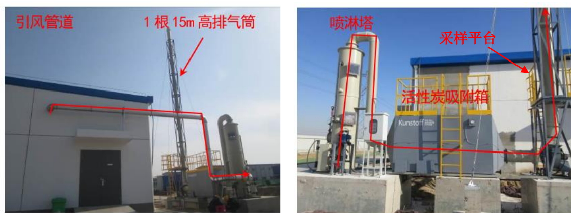
图 4.3-2 2#废气措施采样平台、排气筒
