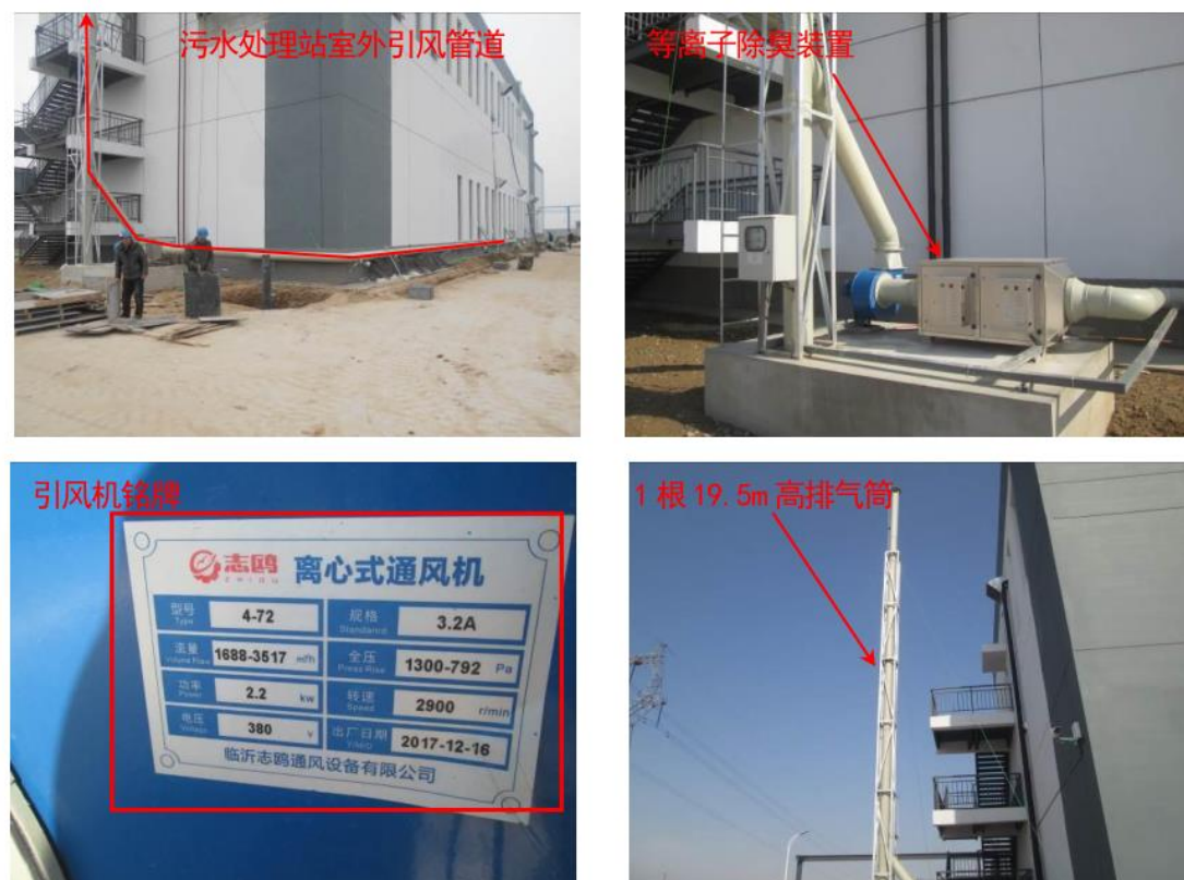
图 4.2-3 3#废气处理措施建设情况
