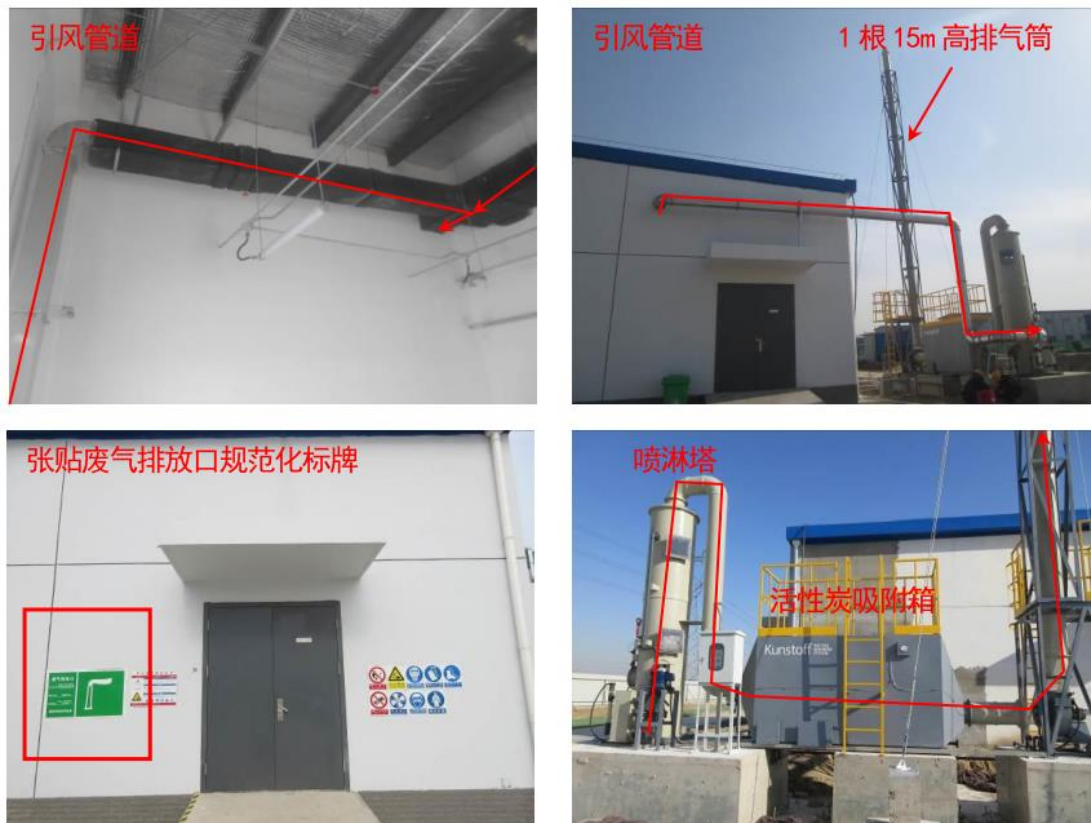
图 4.2-2 2#废气处理措施建设情况
