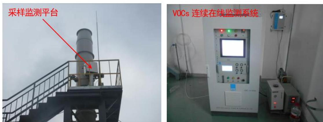
图 4.3-1 1#废气措施采样平台、排气筒、在线监测
