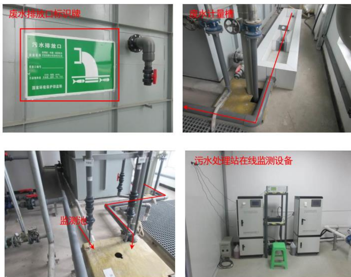
图 4.3-4 废水措施、排放口、在线监测设备
