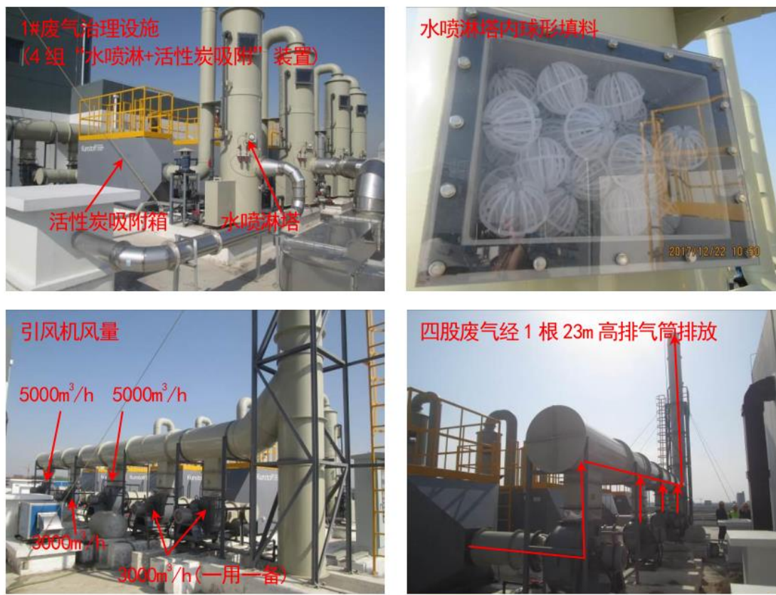
图 4.2-1 1#废气处理措施建设情况
